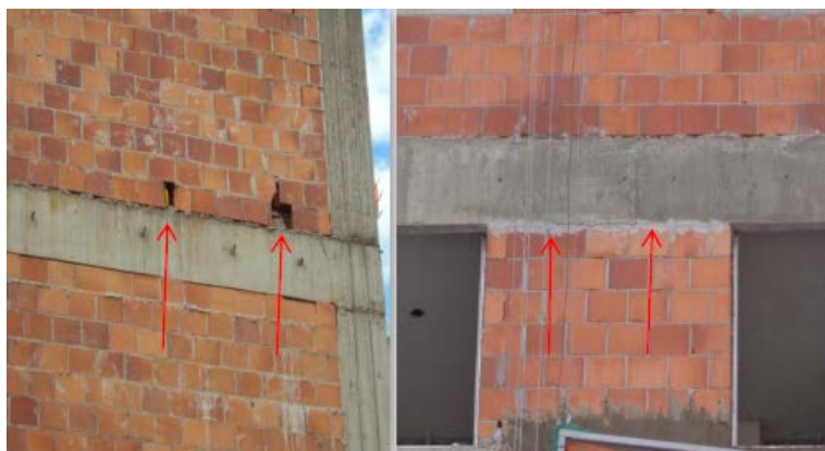
Preparação da base Fechamento de buracos na alvenaria. Encunhamento externo com argamassa Cimento Guaíba apropriada respeitando a espessura de 20 a 30 mm
